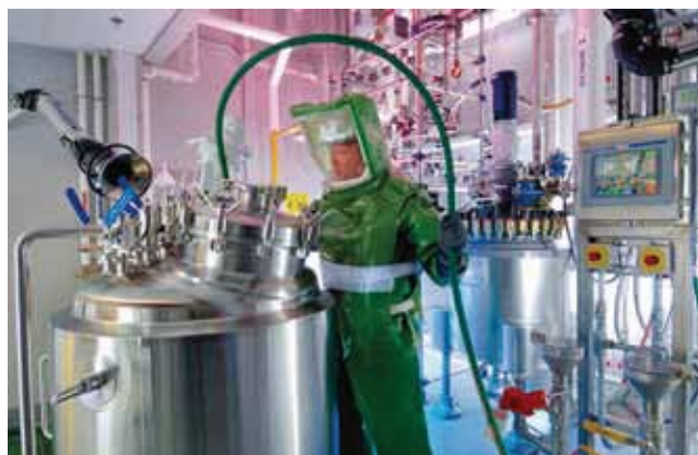
SAFC 公司位于美国威斯康辛州麦迪逊市的试验工厂的高效 API 生产现场。
