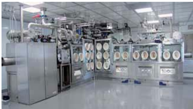
图 2. 采用高度密封隔离器完全集成的临床试验生产线，现场安装。
