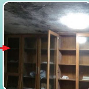
2016年6月27日，使用NS1000后3个月屋顶和壁柜霉菌大部分消除。
