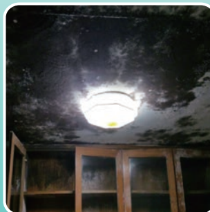
2016年3月25日，霉菌布满屋顶和壁柜。
