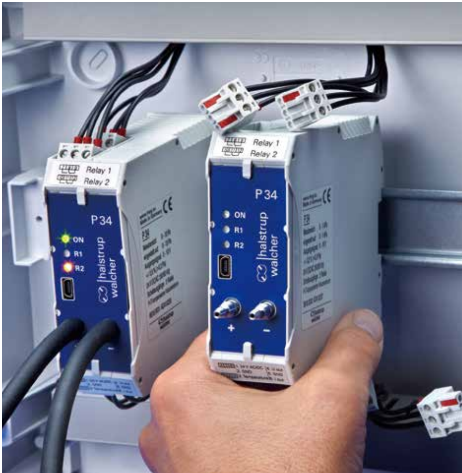
图2. 安装在洁净室监控系统控制柜里的P34压差发送器。
